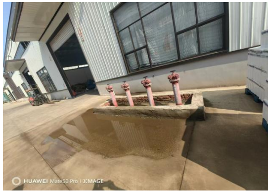
图片 3 厂内消防栓箱及灭火设施
