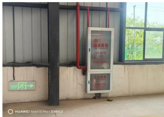
图片 4 生产车间消防栓箱及灭火设施
