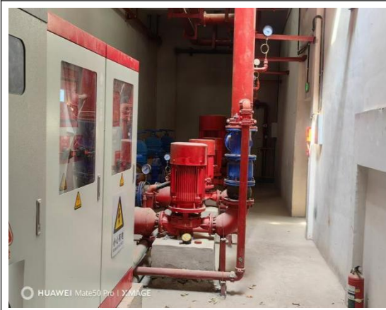
图片 1 厂内消防水泵房
