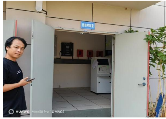
图片 22 消防控制室
