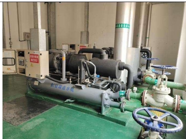
照片 12 冷冻水房
