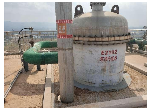
照片 7 塔顶冷凝器
