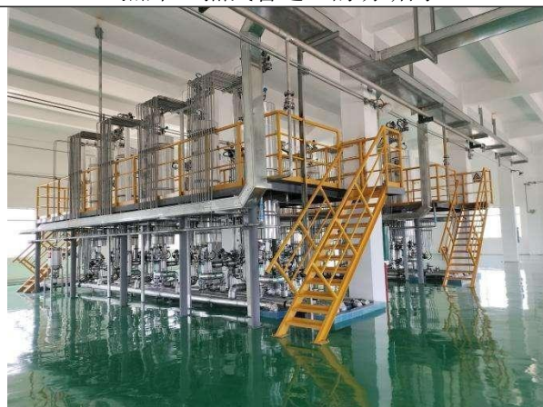
照片 10 电子级车间树脂塔
