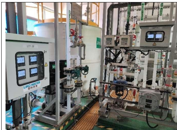
照片 13 纯净水车间
