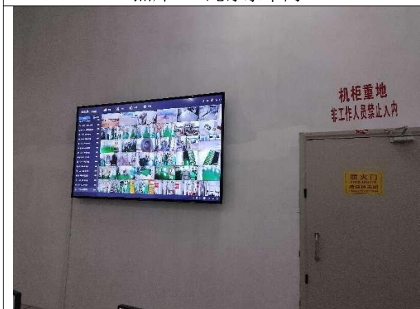
照片 15 控制室内的视频监控
