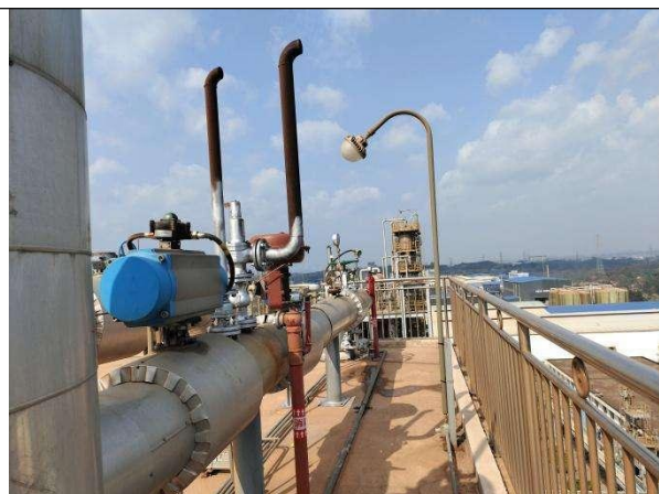
照片 8 蒸汽管道上的切断阀
