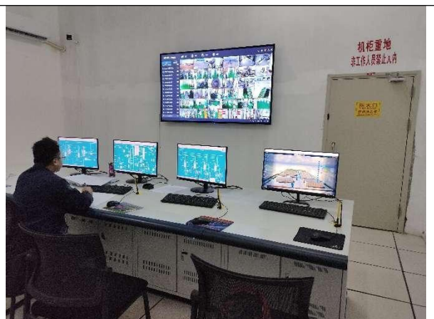
照片 14 DCS 控制室
