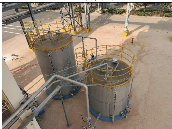
照片 5 双氧水缓冲罐
