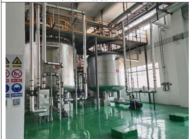
照片 9 电子级车间调配罐
