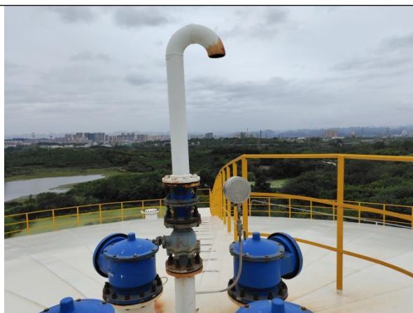
照片 8 罐顶安全附件
