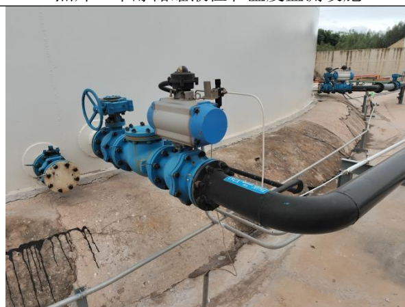
照片 4 DCS 切断阀
