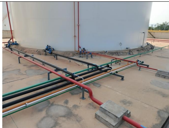
照片 6 消防喷淋和泡沫管道
