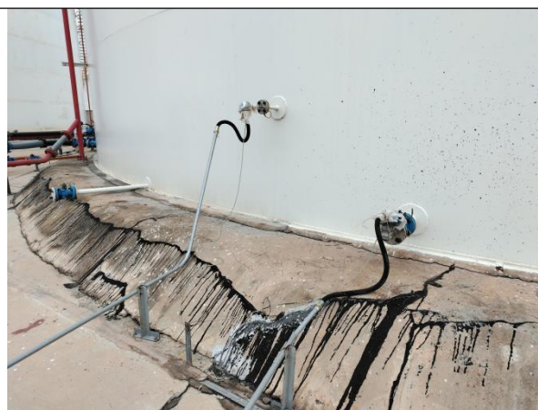
照片 2 甲醇储罐液位和温度监测设施
