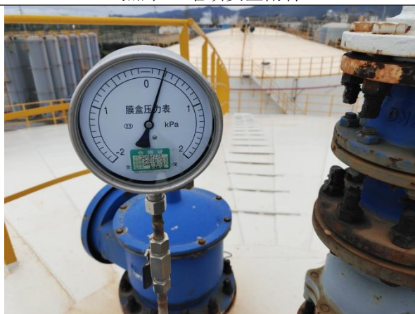
照片 10 罐顶氮封压力表
